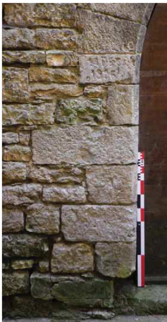
“L'EAU LE 11 DEC 1906” Rue du Moulin du Bessarel
